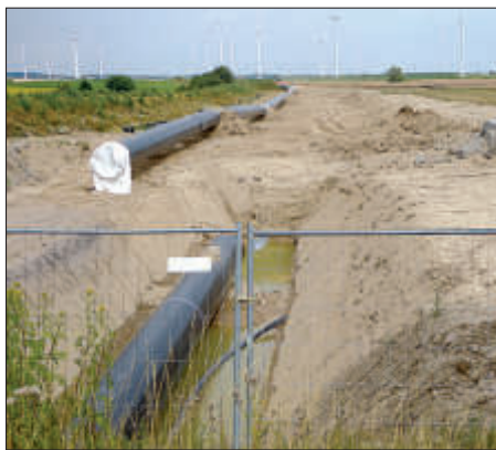
Baufortschritt bei der Erdgasleitung EUGAL bei Lüdersdorf (Juli 2019). Bei einer Bündelung der Trassen und Verlegung der 380kV-Leitung mittels Erdkabel, hätte der Bau längst erledigt sein können
