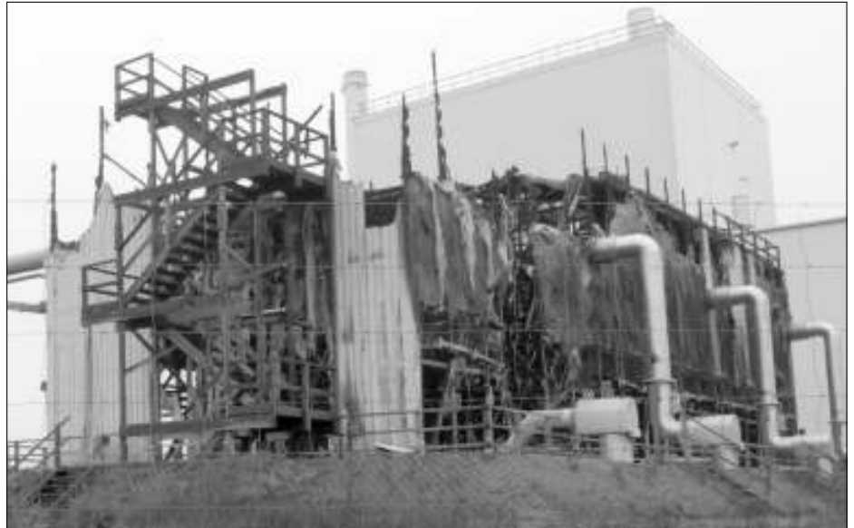
Das abgebrannte Kühlhaus des Holzkraftwerkes Eberswalde (HOKAWE) soll bald wieder aufgebaut werden. Offenbar hat der Insolvenzverwalter Interessenten für einen Weiterbetrieb gefunden. Ob dabei auch die Option einer Fernwärmeversorgung für Eberswalder Stadtteile eine Rolle spielt?
